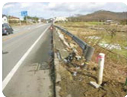
ガードレール・ 標識等の損傷
