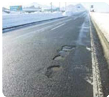
路面の穴ぼこ・ 段差
