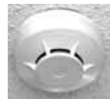
▲火災警報器（天井）
