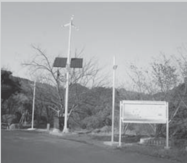
玄関前に設置されたハイブリッド型照明灯
