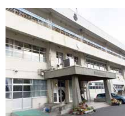
老朽化が目立つ正面玄関外壁
