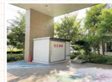
アザレアホール須恵の設置状況
