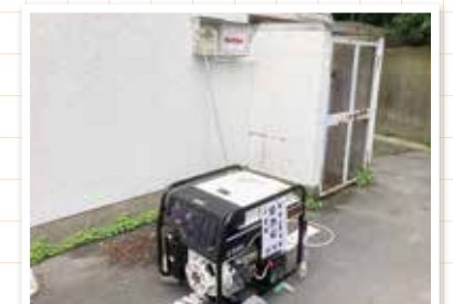
備蓄されている発電機
