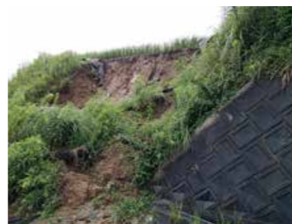
法面が崩壊した農道(佐谷峯畑地区)
