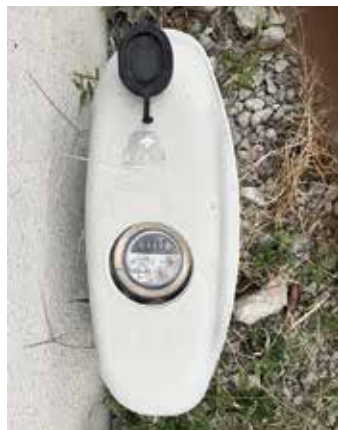
8年に一回交換される水道メーター (メーターボックスは交換されません)
