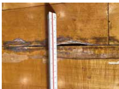
あおば会館2階フロアの劣化状態
