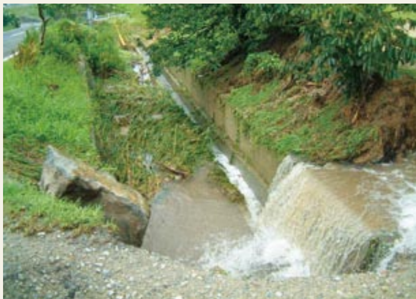
災害日翌日の「上川原水路」 (上須恵：高宮～東原線)
