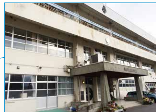
老朽化が目立つ正面玄関外壁
