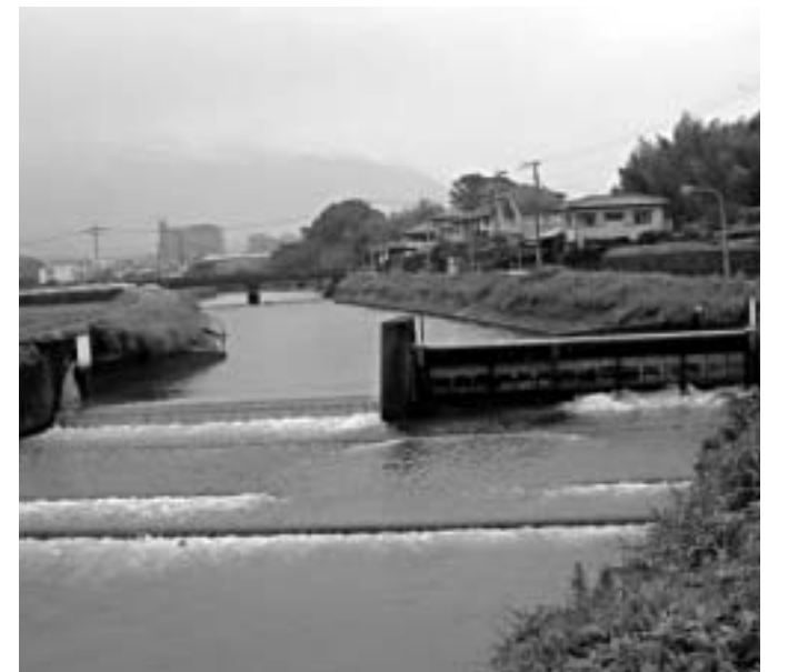
破損した（写真右側）新屋敷堰
