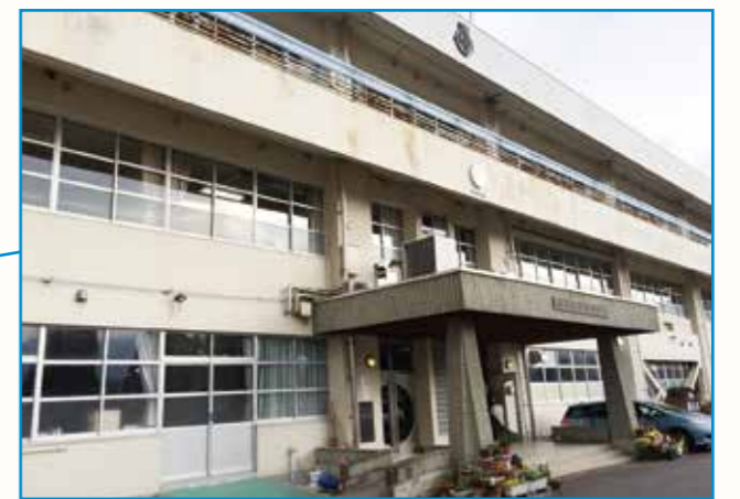
老朽化が目立つ正面玄関外壁
