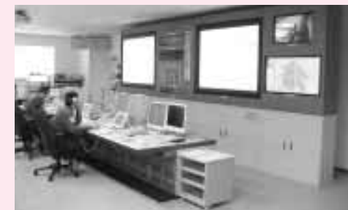
南部消防署新庁舎 通信指令室
