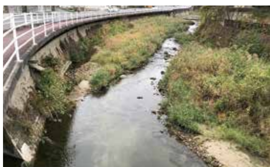
須恵川に堆積した土砂
