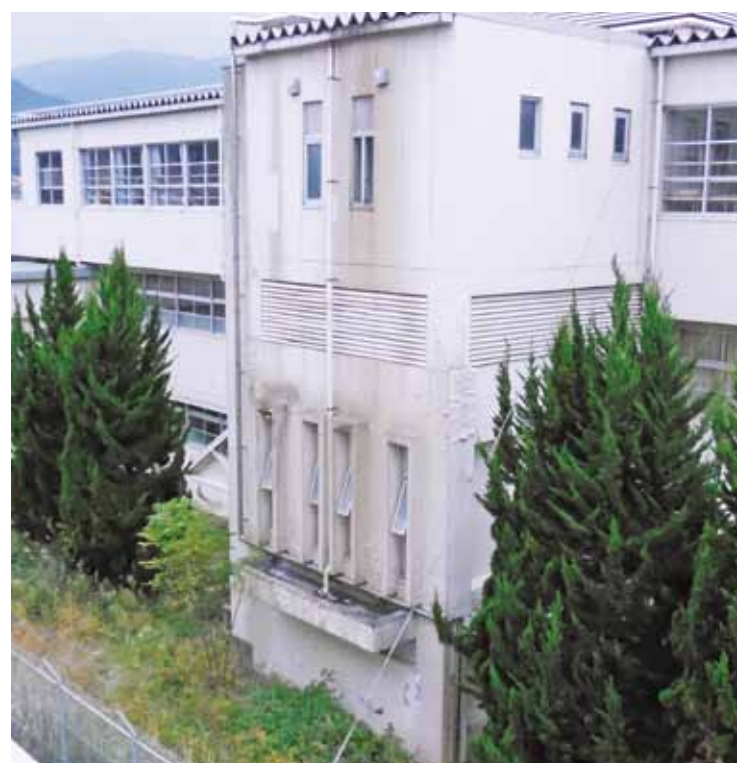
老朽化が進む町有施設
