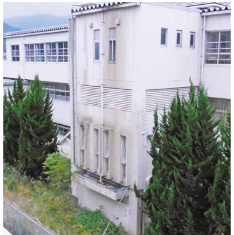
老朽化が進む町有施設
